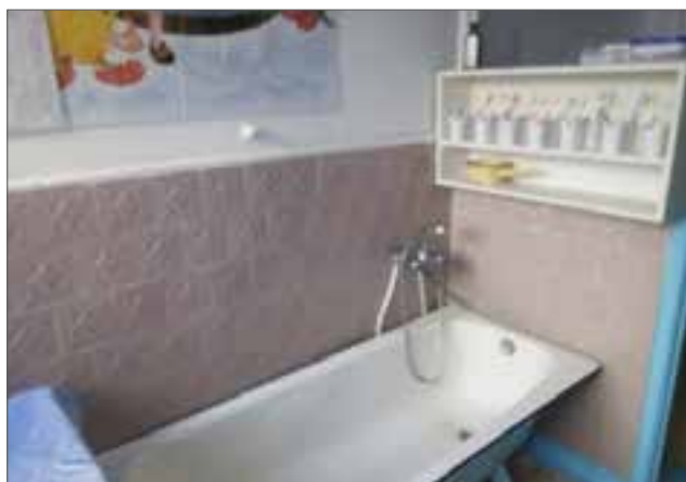
Відсутність в ванній кімнаті права на приватність. Ванна кімната об'єднана з туалетною кімнатною. Стіни та підлога туалетної кімнати потребують ремонту.
