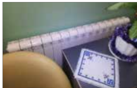
Фрагмент нового теплокомунікаційного обладнання спальної кімнати дитячого відділення
